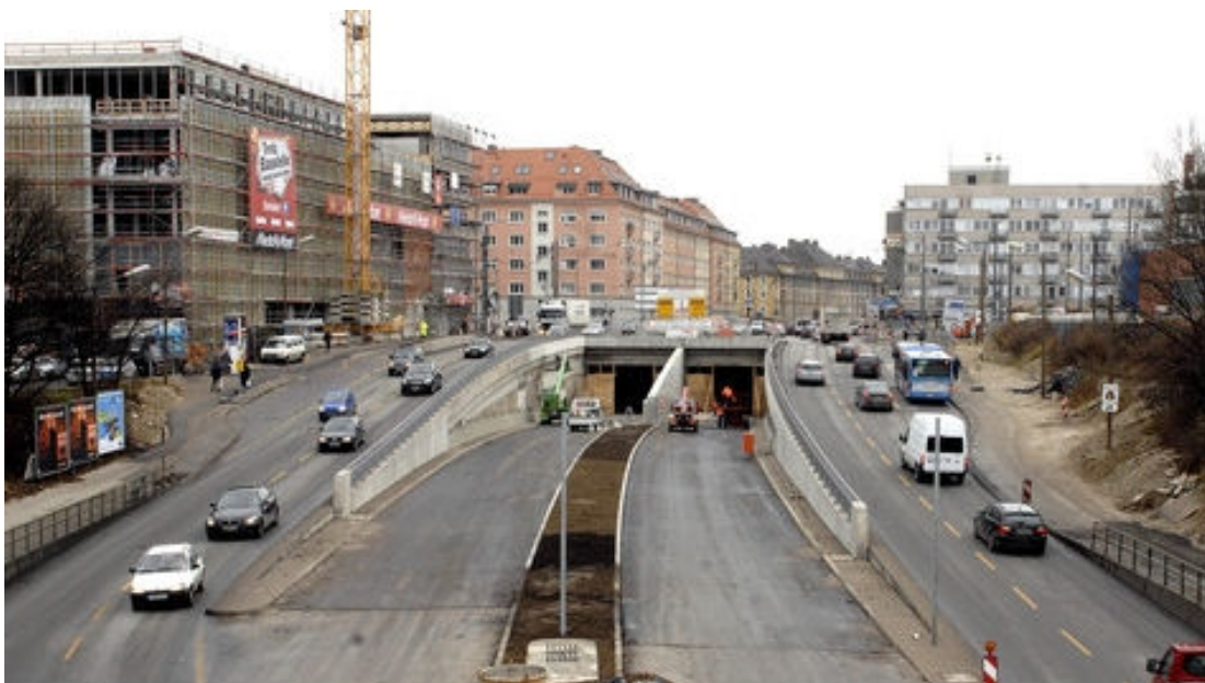
Aanbouw van een tunnelingang van de Richard Strausstunnel, München, Het verkeer wordt langs de bouwplaats geleid.
